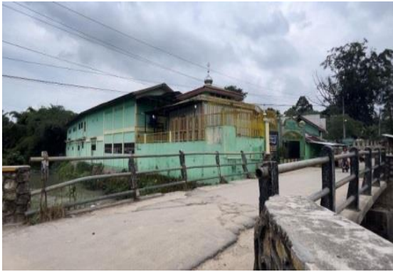
Gambar 1. Kondisi Jembatan di Lingkungan Pasar Bawah
