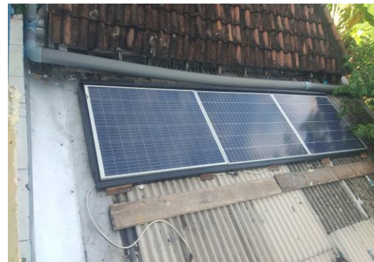
Gambar 5. Modul Photovoltaic Yang Digunakan Sebagai Sumber Energi Utama Sistem.
