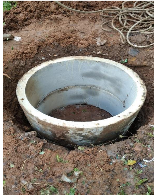
Gambar 5. Sumur resapan dari bus beton diameter 80 cm
