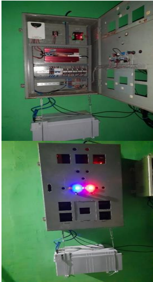
Gambar 11. Panel kontrol panel surya sudah dapat dioperasikan
