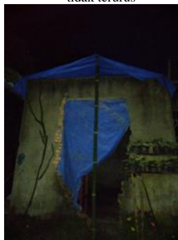
Gambar 11. Kondisi puing bangunan yang sudah dijadikan kumbung jamur
