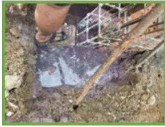
Gambar 2. Pembuangan Limbah di lokasi pembangunan
