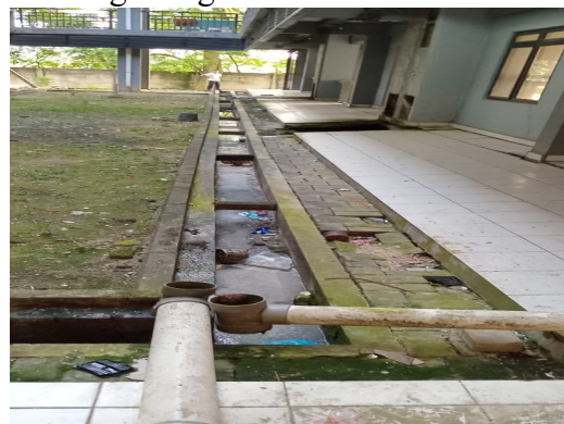
Gambar 7: Fasilitas Rusunawa Yang Rusak.
