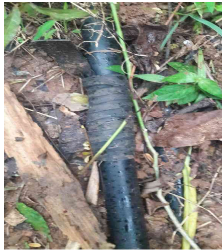
Gambar 5. Pipa rusak yang belum diperbaiki
