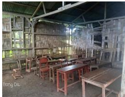
Gambar 2. Fasilitas kelas yang rusak
